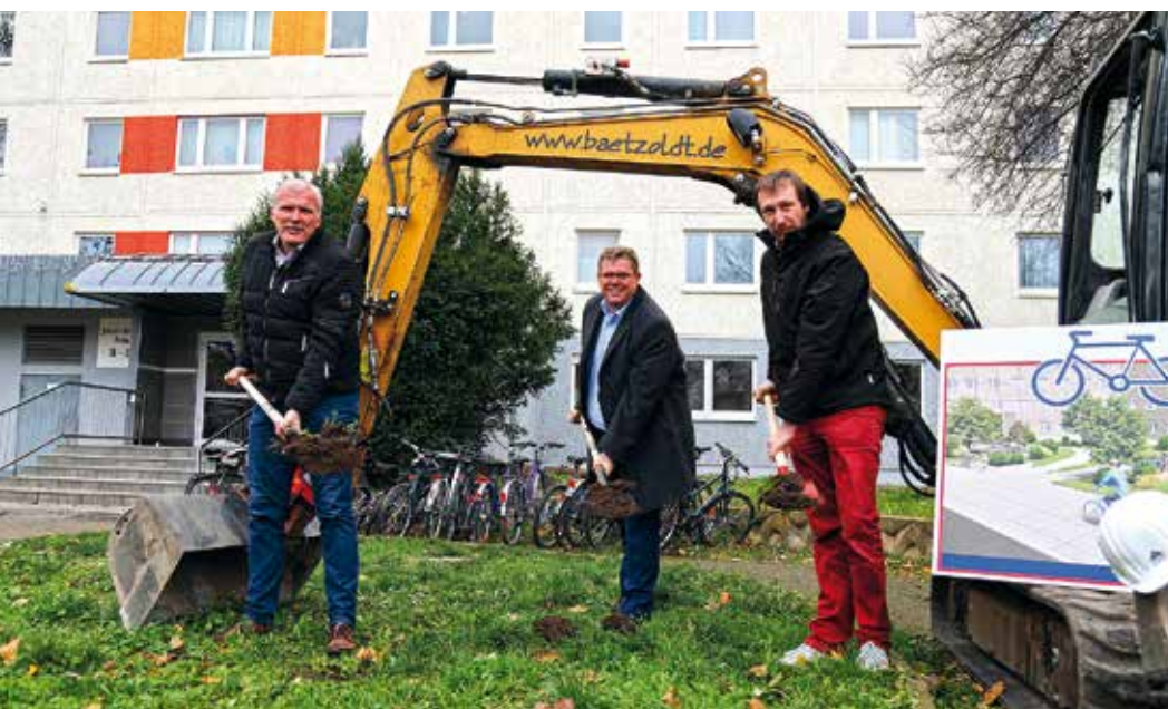
Oberbürgermeister Andreas Bausewein, KoWo-Geschäftsführer Alexander Hilge und Projektleiter Jörg Heckel beim Spatenstich für die neue Radabstellanlage am Roten Berg
